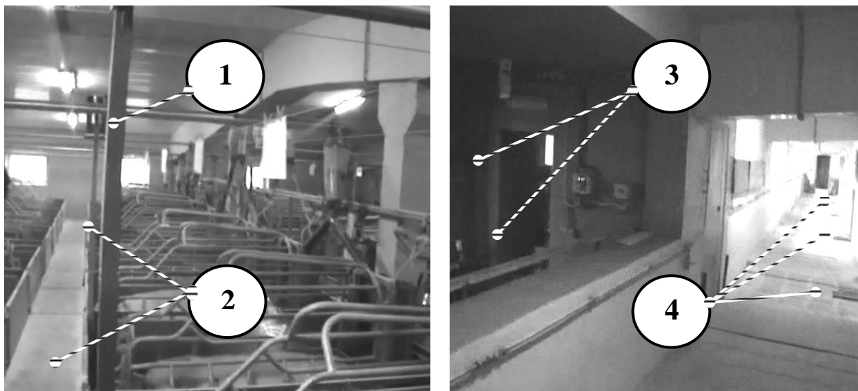
Рис.2 Загальний вигляд секції для опоросу в приміщенні №3 та системи припливу повітря (II дослідна група)
